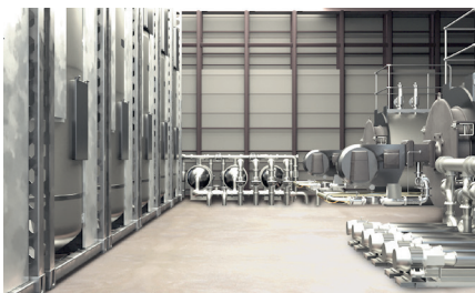
Chemie-Produktion mit Silos und Rohrleitungen
