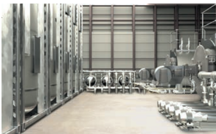
Chemie-Produktion mit Silos und Rohrleitungen
